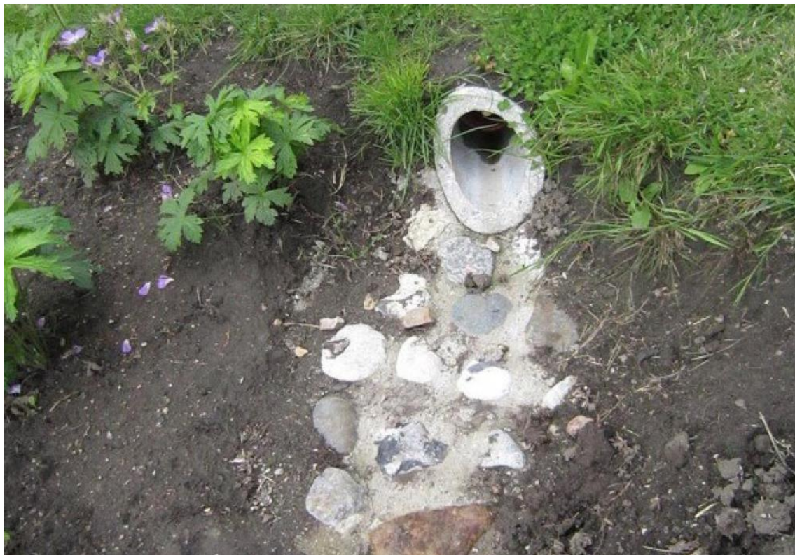
Figur 1 Ulovligt udløb til vejgrøft.
